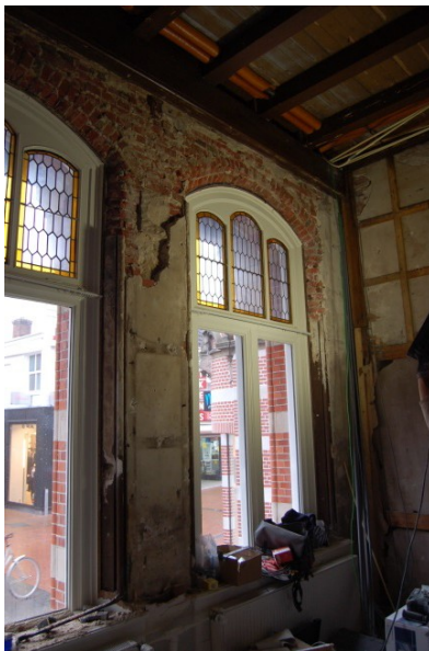
In slechte staat verkerende stucwanden
