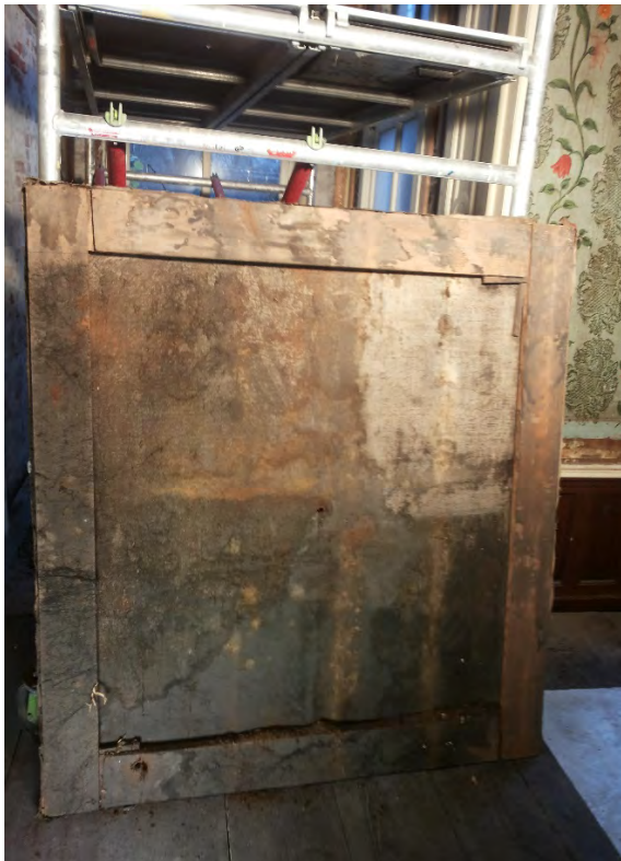
Afb. 4c - spanraam met deels gereinigde hoek
